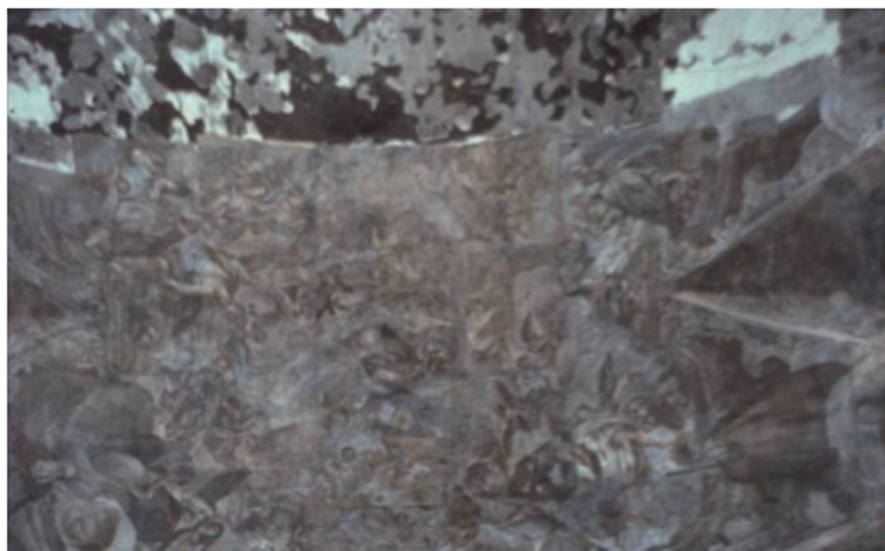
F-07.- Zona de los dos lunetos junto al muro hastial de la bóveda de la Iglesia de los Santos Juanes, antes de nuestra actuación de restauración.
