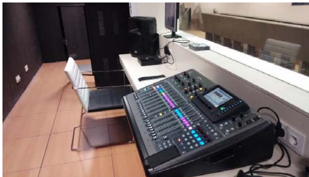
Vista del equipamiento electrónico para el control de la instalación desde la sala técnica
