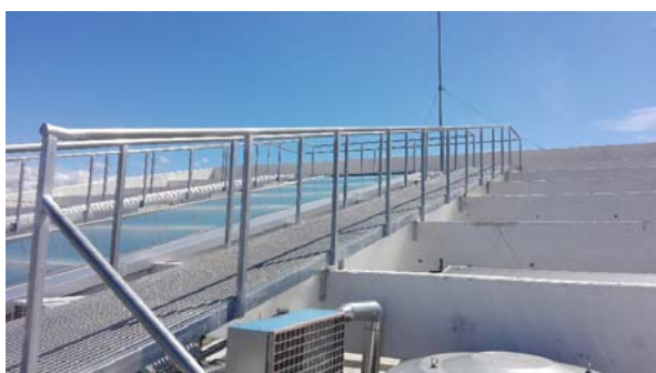
Vista de la nueva pasarela para mayor seguridad en las tareas de mantenimiento
