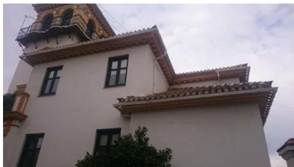
Vista de los aleros, canales y bajantes reparados en el Centro de Lenguas Modernas
