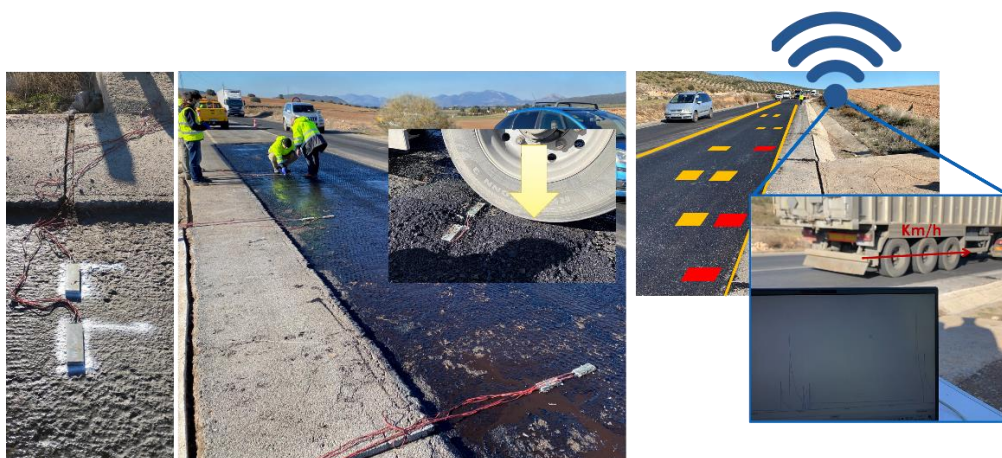
Figura 10. Detalle de sensores desarrollados por LabIC.UGR utilizados en la monitorización del tráfico en la carretera A-308.
